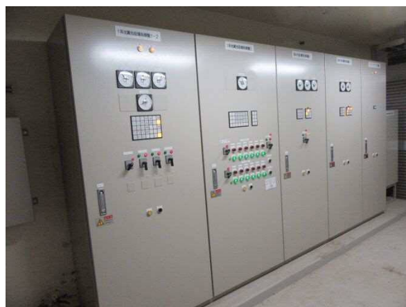
<沈殿池制御盤>
